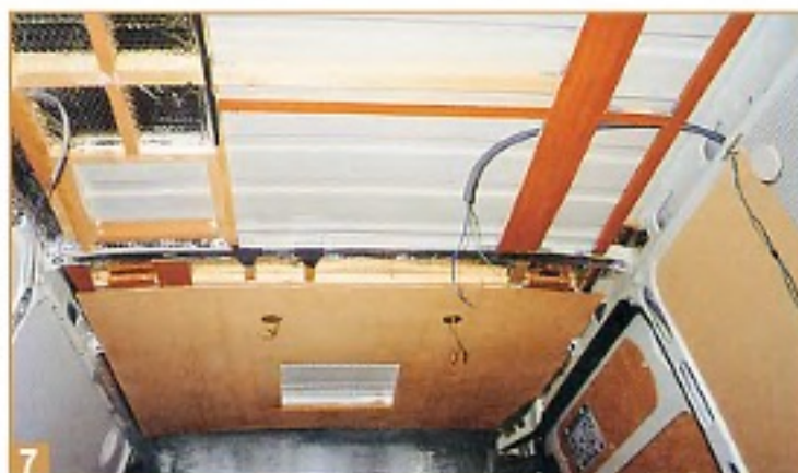
Изолированные электрокабели проведены в коробах и пропущены под кронштейнами.
