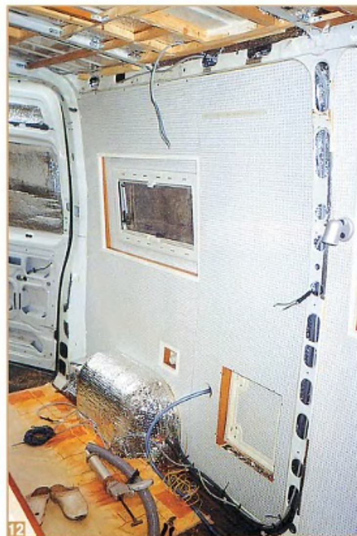
После прокладки электрического кабеля в коробах корпуса фургона салон обшивают 3-мм листами фанеры, которые ставят на клей и закрепляют винтами.
